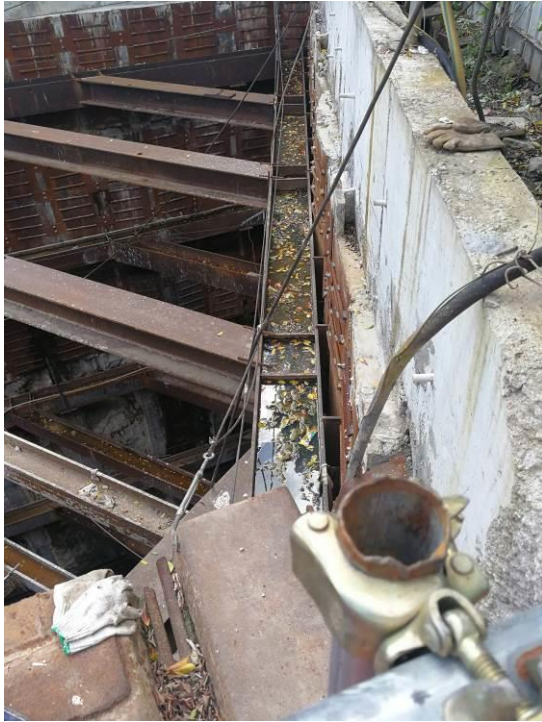
檢查發現地盤鋼梁上有大量積水，已即時要求處理。
